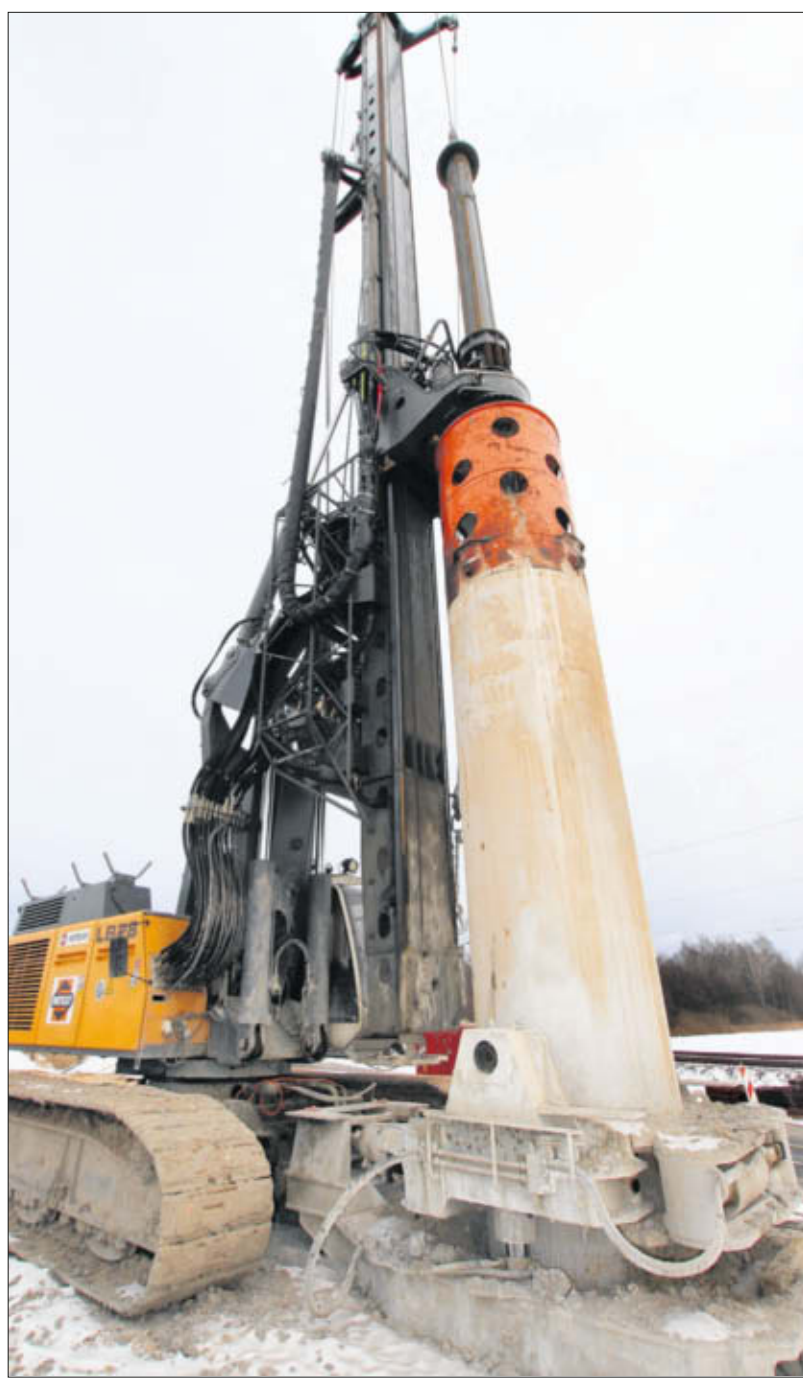
Schwere Bautechnik zwischen dem Kreisel Plüggenthin und Zirkow Hof nördlich Samtens. Hier wird tonnenweise Erde bewegt. Foto: Berndt
