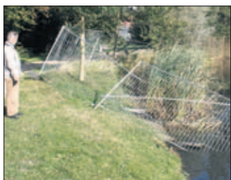
Der Zaun am Teich in Rotensee ist komplett zerstört.
